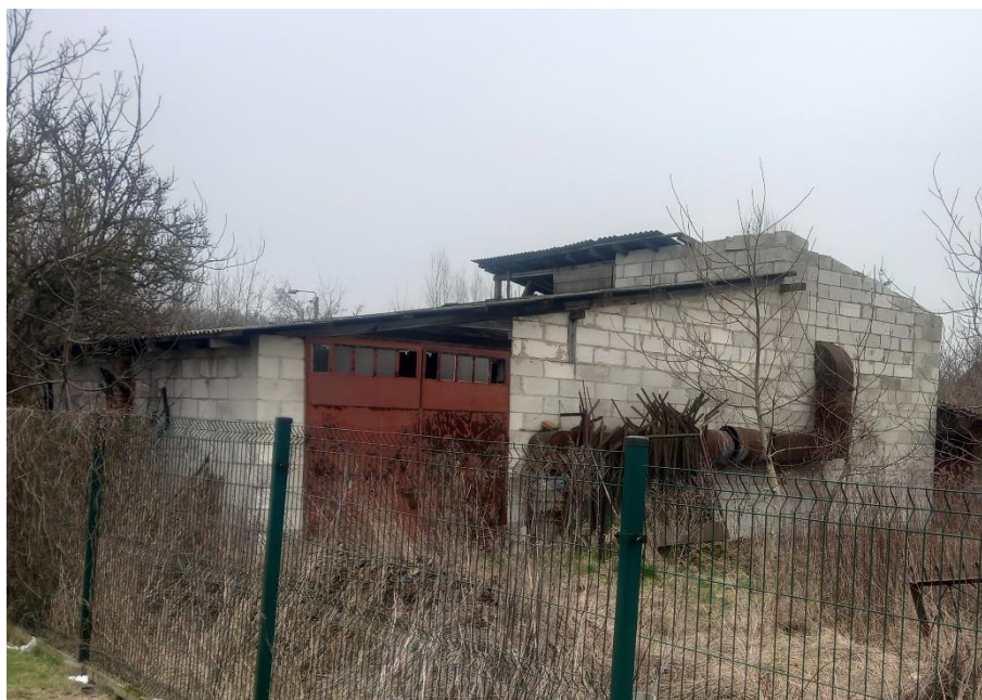
Zdjęcie 10 Zabudowa w złym stanie technicznym przy ul. Włostowickiej (źródło: zdjęcie własne)
